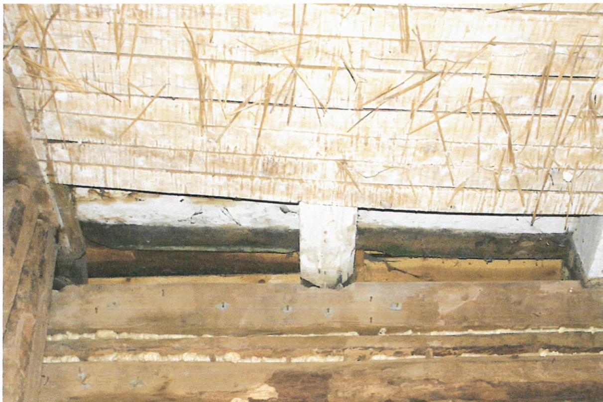
Uzupełnienie zewnętrznej ściany zachodniej pomiędzy belkami stropowymi - Poz. 14. Końcówki belek stropowych nad piętnem w obrębie ściany zewnętrznej zachodniej są nie połączone ze ścianą wieńcową, belki są podniesione nad ścianę wieńcową. Brak wypełnienia ściany wieńcowej pomiędzy belkami stropu. Fot. Olgierd Pietrzak, maj 2020 r.
