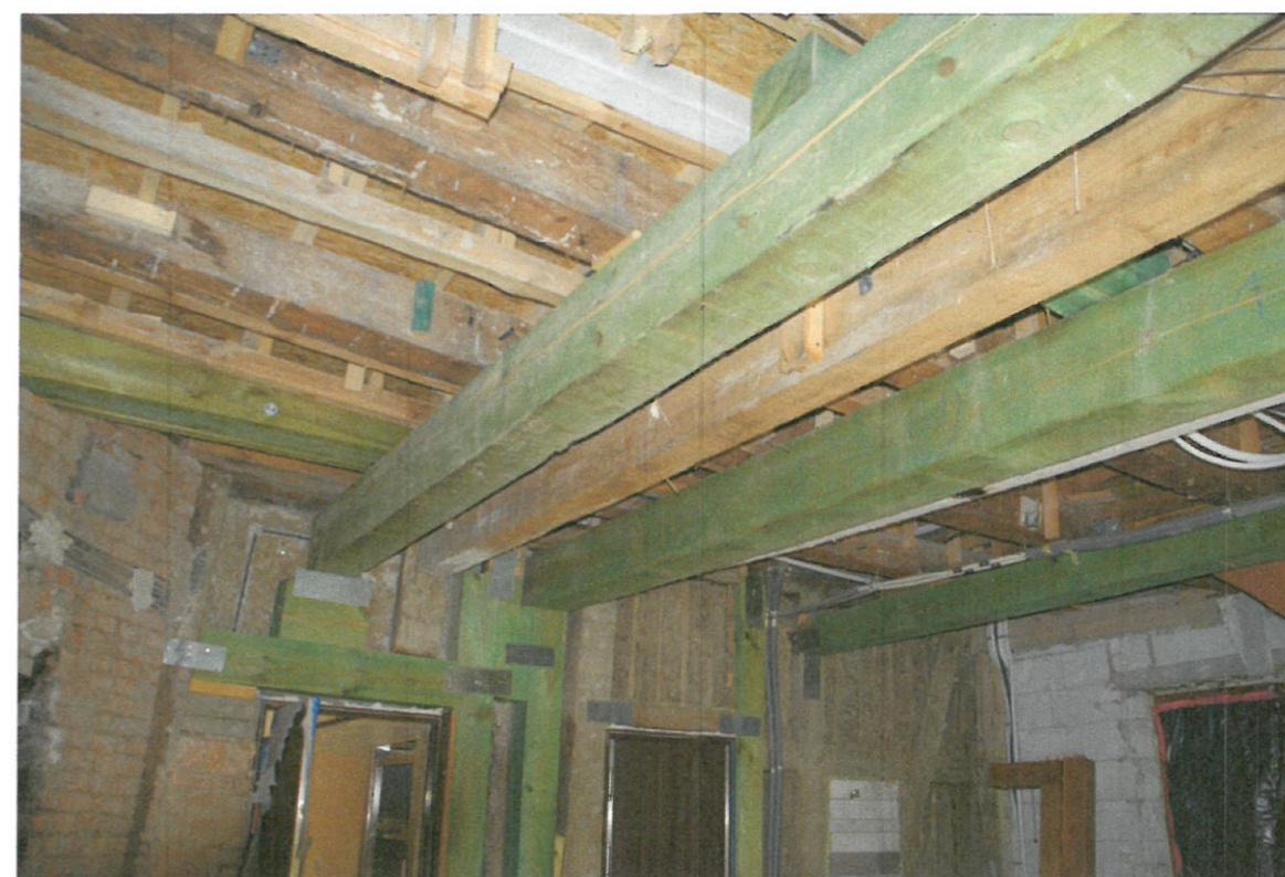
Podciąg Poz. 1, Poz. 2A, Poz. 2B wykonane z drewna konstrukcyjnego w lokalizacji niezgodnej z projektem. Fot. Olgierd Pietrzak, maj 2020 r.
