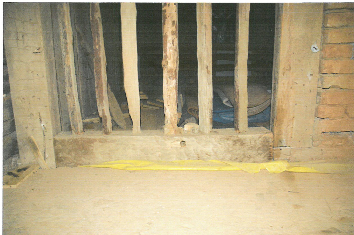
Zdekompletowana ściana szkieletowa piętra do odtworzenia - Poz. 12. Brak odtworzenia ciągłości belki podwalinowej. Fot. Olgierd Pietrzak, maj 2020 r.
