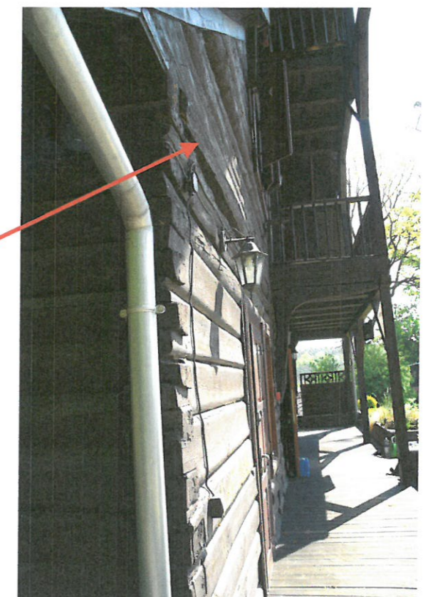
Ściana południowa. Wysunięta belka. Fot. Olgierd Pietrzak, maj 2020 r.
