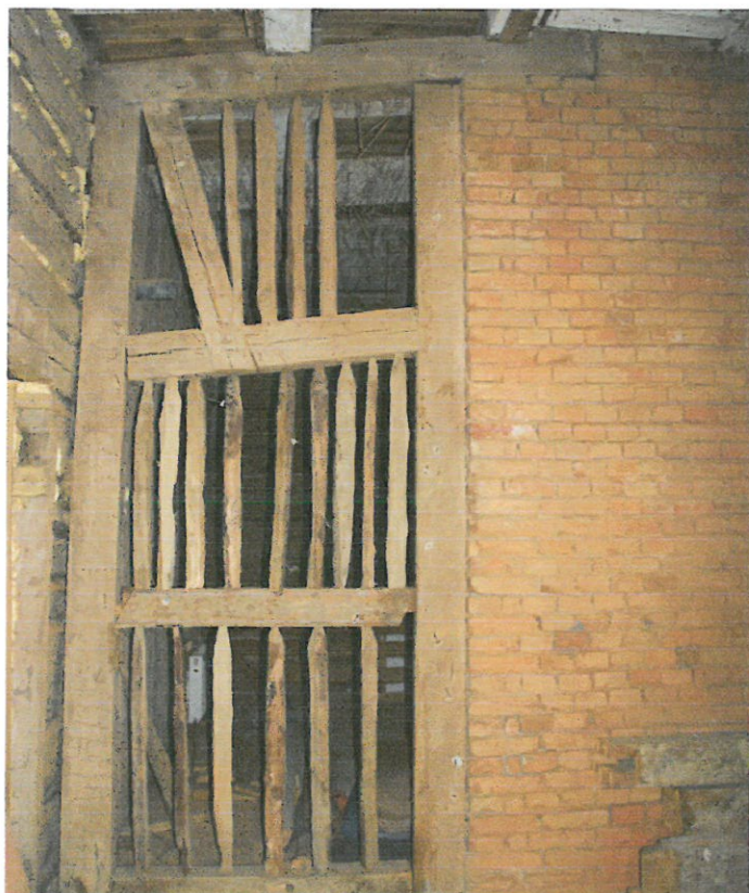
Zdekompletowana ściana szkieletowa piętra do odtworzenia - Poz. 12. Brak odtworzenia zastrzału, brak ciągłości podwaliny oraz brak tradycyjnych złączy ciesielskich. Fot. Olgierd Pietrzak, maj 2020 r.
