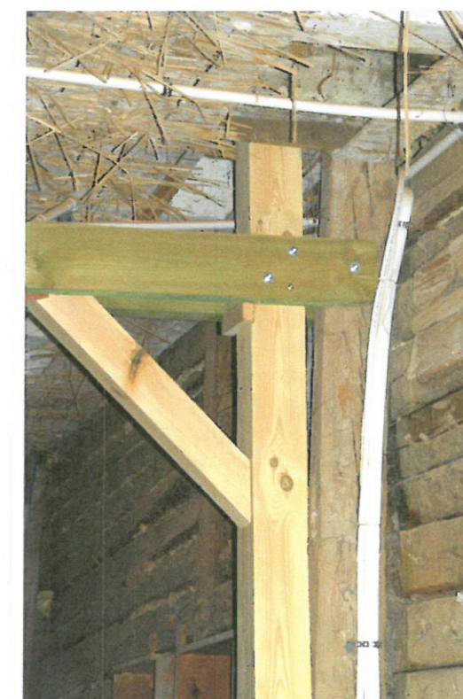
Ściana wewnętrzna piętra Poz. 11. Widoczne zdublowanie słupa. Fot. Olgierd Pietrzak, maj 2020 r.
