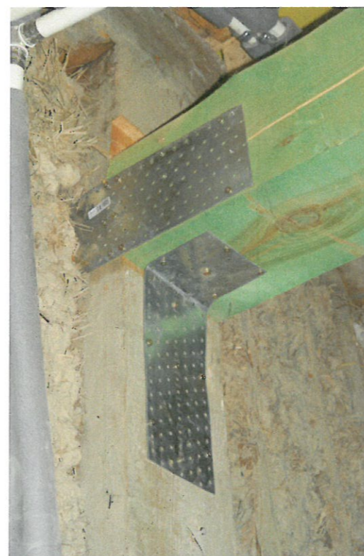
Podciąg Poz. 2B, mocowanie belki niezgodne z projektem (brak złączy systemowych Simpson Strong Tie ze wspornikiem belek BSD 200/200). Fot. Olgierd Pietrzak, maj 2020 r.
