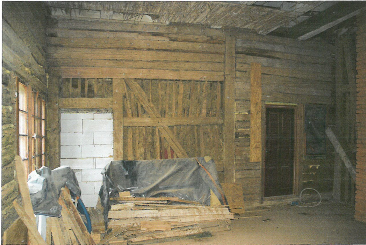
Zdekompletowana ściana szkieletowa piętra do odtworzenia - Poz. 13. Nie usunięto wtórnego wypełnienia z bloczków z betonu komórkowego i nie odtworzono elementów drewnianych ściany szkieletowej. Fot. Olgierd Pietrzak, maj 2020 r.
