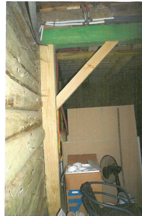
Rama drewniana Poz. 4. Brak połączenia słupa drewnianego ze ścianą zewnętrzną prętami gwintowanymi 3 x M20 KL 8.8. Fot. Beata Pietrzak, styczeń 2020 r.
