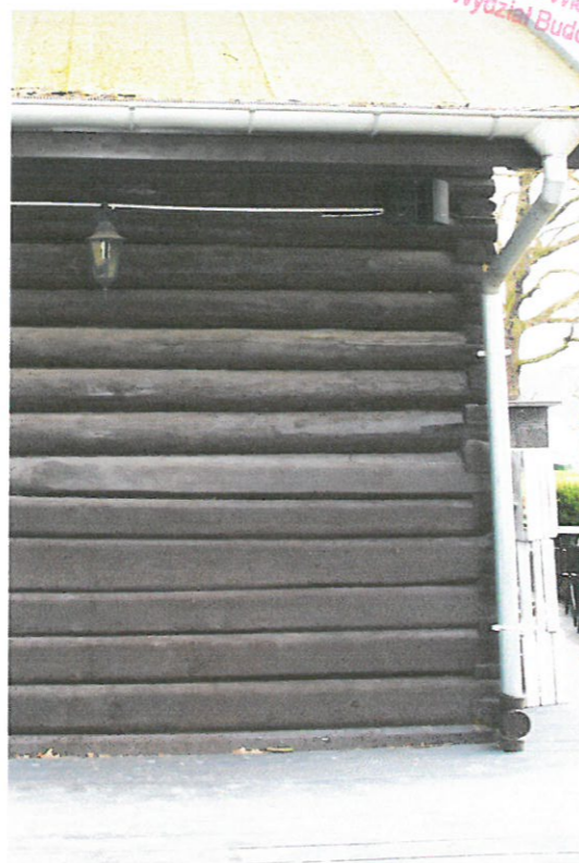
Taras od strony zachodniej. Odprowadzenie wody opadowej w przestrzeń podtarasową. Takie rozwiązanie powoduje brak możliwości kontroli drożności instalacji deszczowej. Fot. Olgierd Pietrzak, luty 2018 r.
