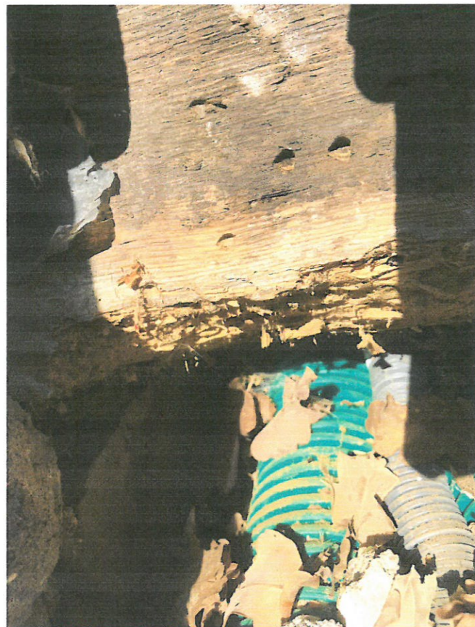
Podwalina wschodniej ściany wieńcowej. Widoczna korozja biologiczna drewna. Fot. Olgierd Pietrzak, maj 2020 r.
