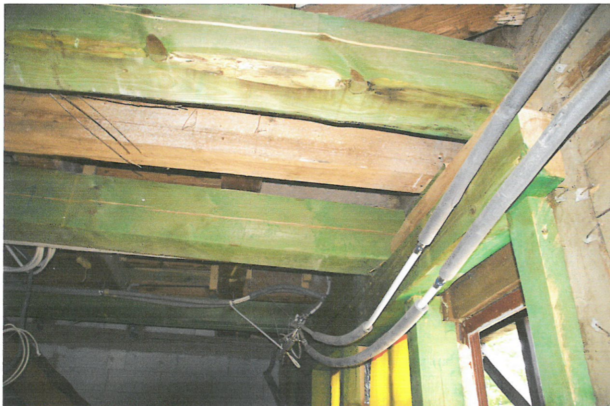
Ściana południowa parteru. Zamiast wymiany „uszkodzonej konstrukcji ściany na belki o takich samych wymiarach jak w oryginalnej konstrukcji” dostawiono do ściany zewnętrznej od wewnątrz konstrukcję szkieletową. Fot. Olgierd Pietrzak, maj 2020 r.
