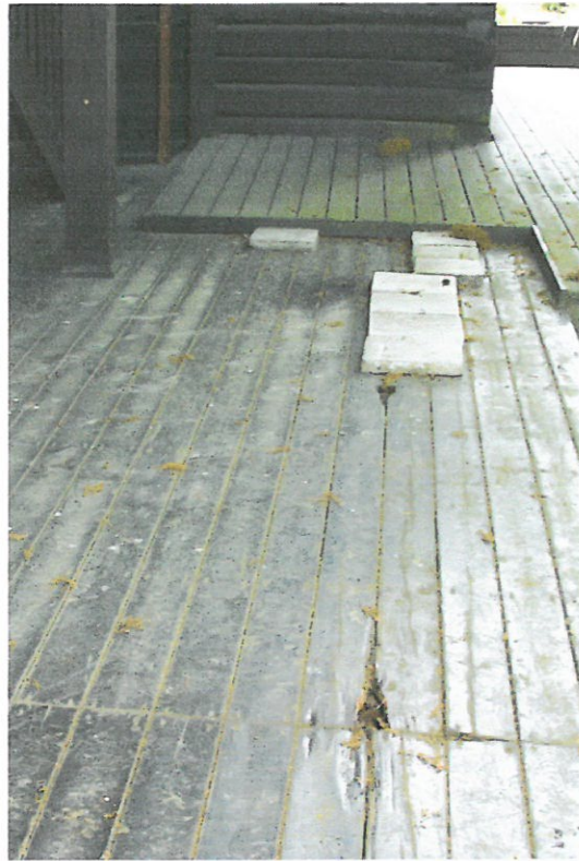
Taras od strony zachodniej. Widoczna korozja biologiczna desek tarasowych. Fot. Olgierd Pietrzak, maj 2020 r.
