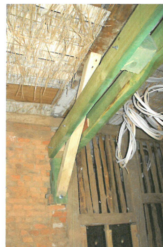
Ściana wewnętrzna piętra Poz. 11. Brak projektowanego słupa Poz. 11.1, Fot. Olgierd Pietrzak, maj 2020 r.
