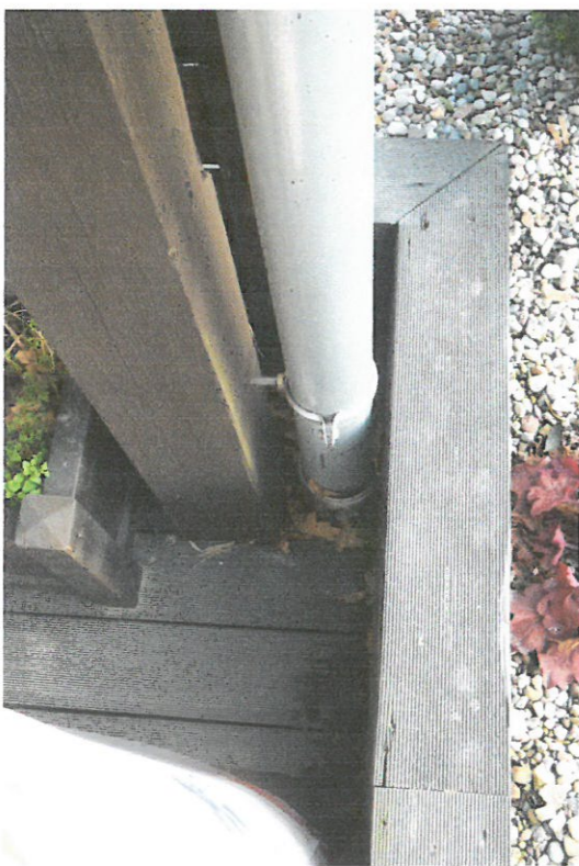
Odprowadzenie wody opadowej bez możliwości kontroli drożności instalacji deszczowej. Fot. Olgierd Pietrzak, maj 2020 r.
