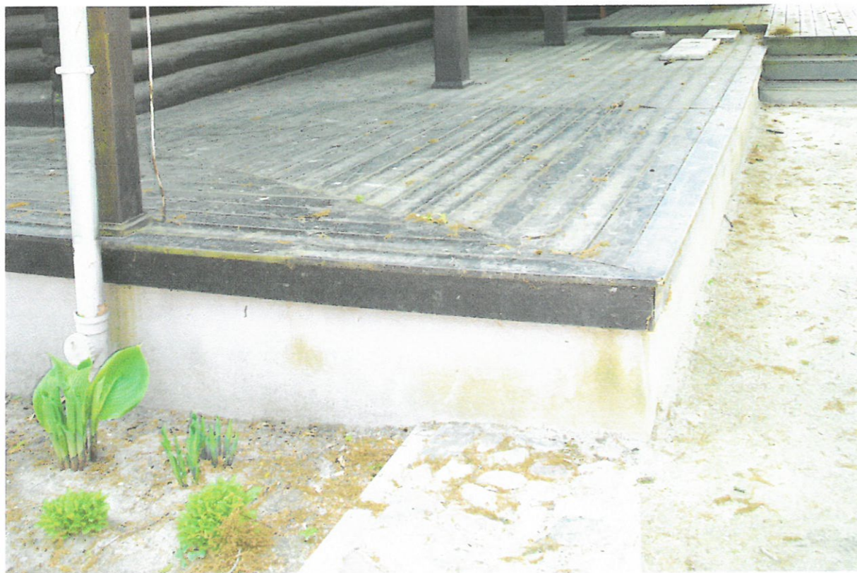
Taras od strony północno zachodniej. Widoczny brak wentylacji i odwodnienia obszaru pod tarasem. Fot. Olgierd Pietrzak, maj 2020 r.
