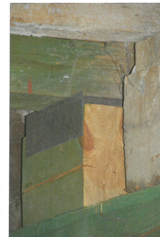
Podciąg Poz. 2A, mocowanie belki niezgodne z projektem (brak złączy systemowych Simpson Strong Tie ze wspornikiem belek BSD 200/200). Fot. Olgierd Pietrzak, maj 2020 r.
