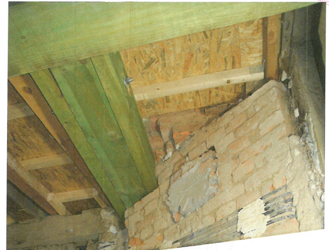
Naprawa belki stropowej Poz. 5. Brak projektowanego oparcia. Fot. Olgierd Pietrzak, maj 2020 r.
